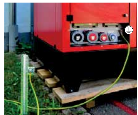
Abb. 15 Stromerzeuger mit Erdungsanschluss und Erdspieß
