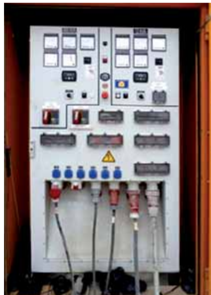
Abb. 14 Anschlussfeld eines Stromerzeugers mit integrierten RCDs
