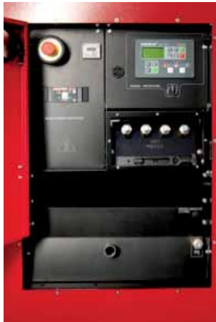
Abb. 16 Stromerzeuger mit Überstromschutz, aber ohne integrierte Maßnahmen zum Personenschutz
