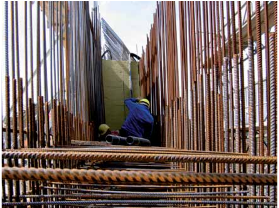
Abb. 19 Beispiel für erhöhte elektrische Gefährdung
