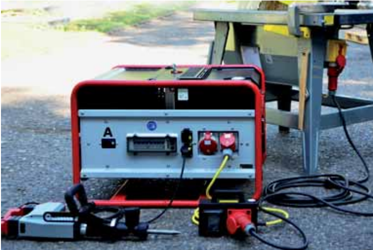
Abb. 23 Zwei Betriebsmittel – Abbruchhammer direkt angeschlossen, Baustellenkreissäge mit zwischengeschalteter vierpoliger RCD in einem Verteiler
