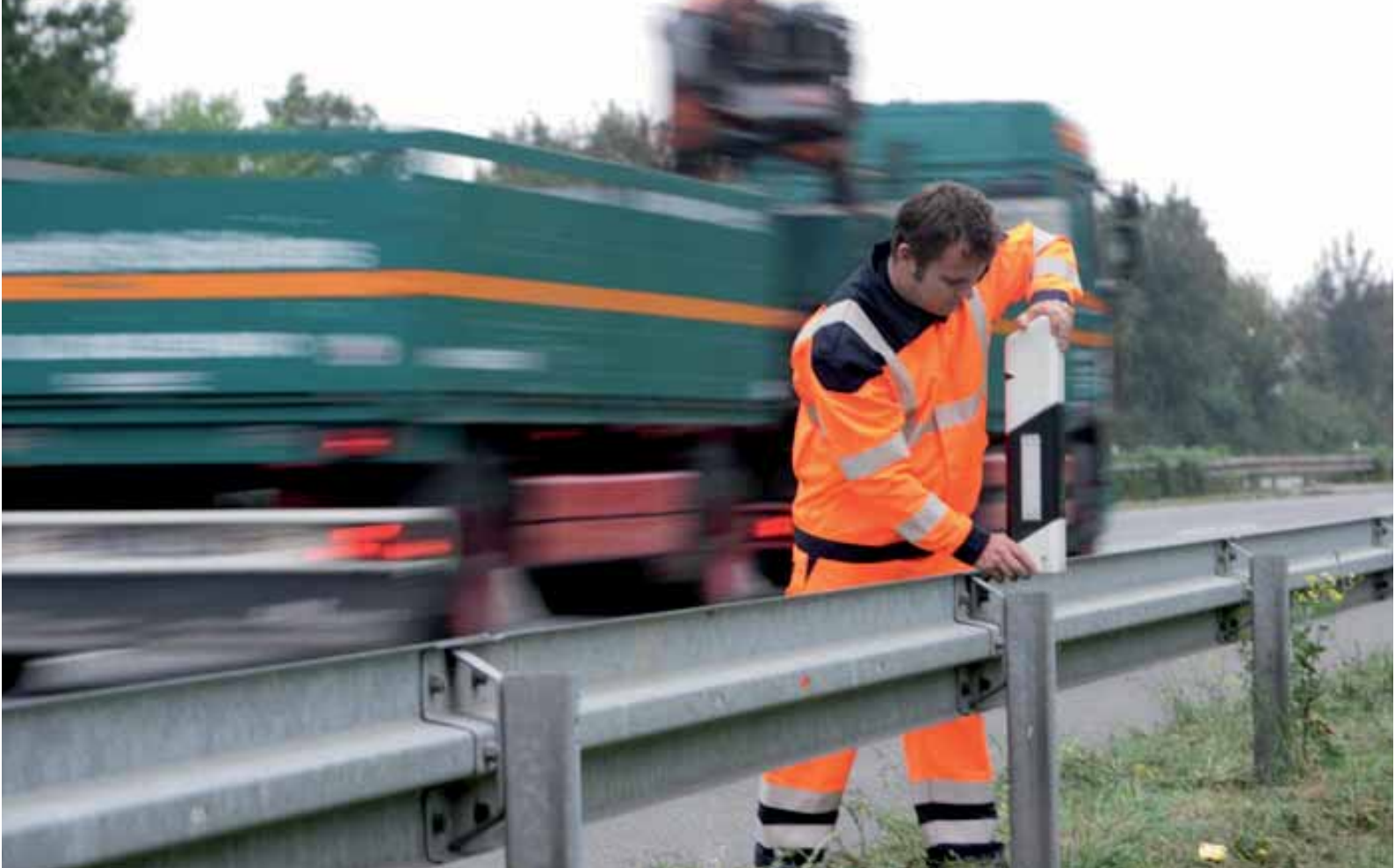
Abbildung 1: Gefahr des unbeabsichtigten Hineingeratens in den fließenden Verkehr
