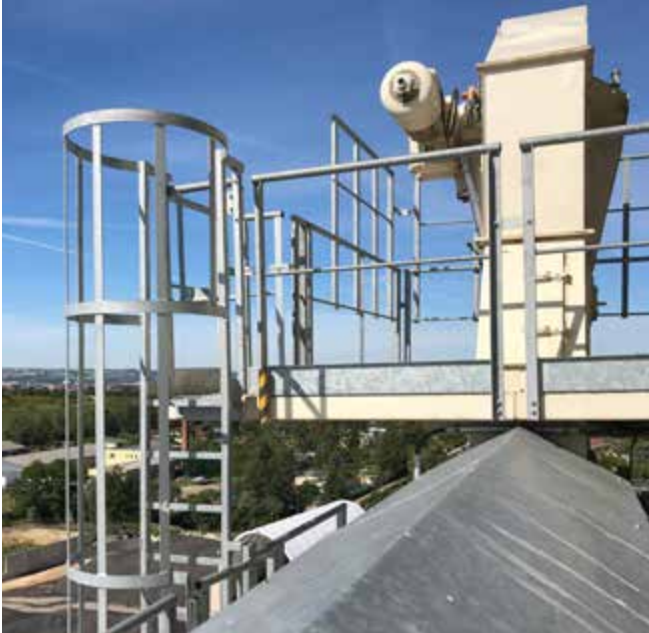
Abb. 59 Sichere Verkehrswege am Becherwerkskopf und abgedeckte Übergaberinne in die Paralleltrommel
