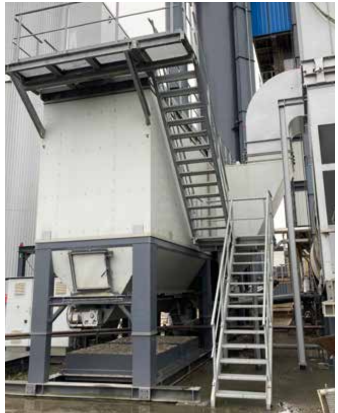
Abb. 39 Treppe als Zugang zur Wartungsbühne der Filteranlage
