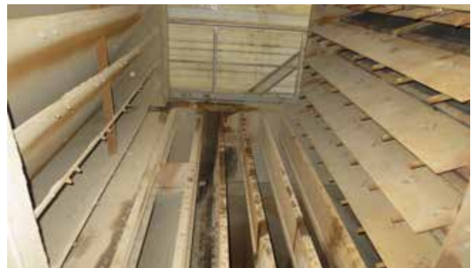
Abb. 79 Geöffnete Siebanlage mit noch nicht abgedeckten Heißmineraltaschen
