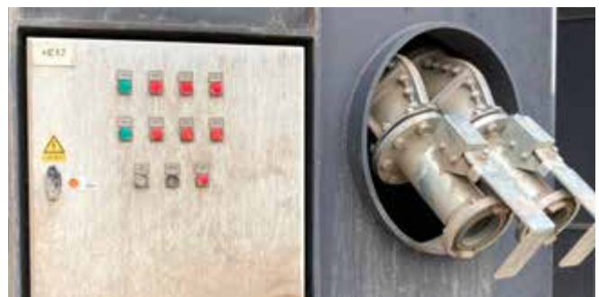
Abb. 13 Abschaltventil am Einblasstutzen für Füller
