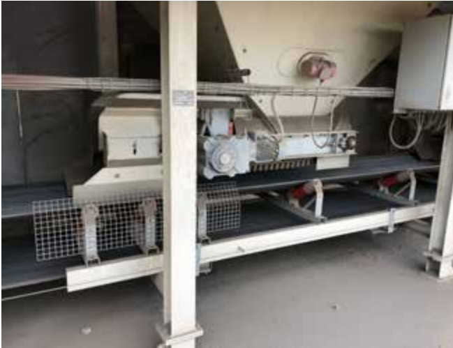
Abb. 31 Schutzeinrichtung an Abzugsbändern unter den Doseuren
