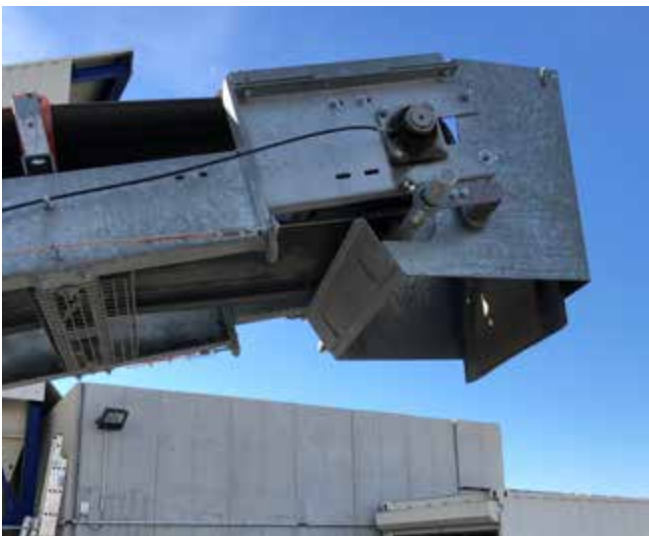
Abb. 32 Förderband mit Abstreifer
