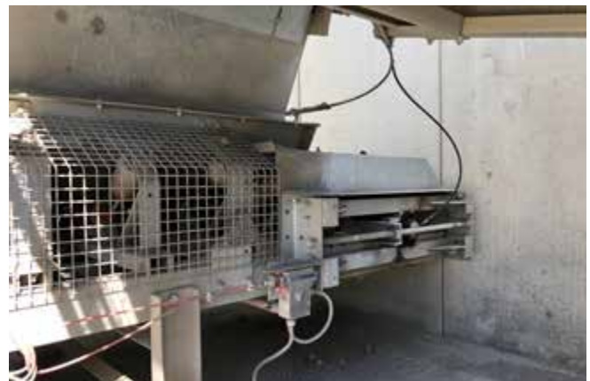
Abb. 66 Spanneinrichtung an Förderband
