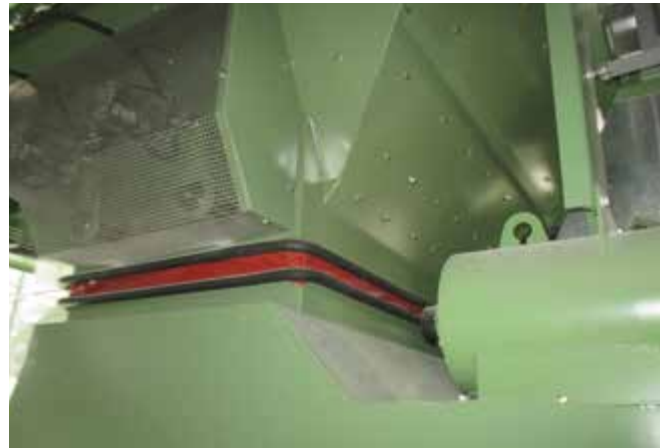
Abb. 46 Kompensationsmaterial am Übergang Waage/ Mischer
