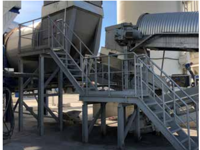
Abb. 75 Treppe und Arbeitsbühne als Zugang zur Wartungsklappe
