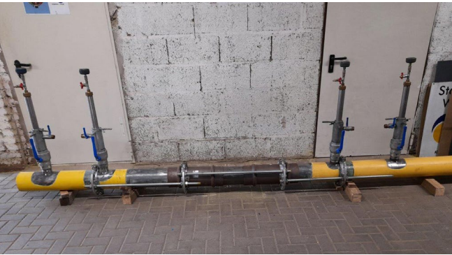
Abb. 11 Beispiel für eine formschlüssige Konstruktion zur Fixierung des Rohrendes. Fixpunkte sind Blasen-setzstutzen und Durchmesserabstufung am Überschieber. (Haibach)
