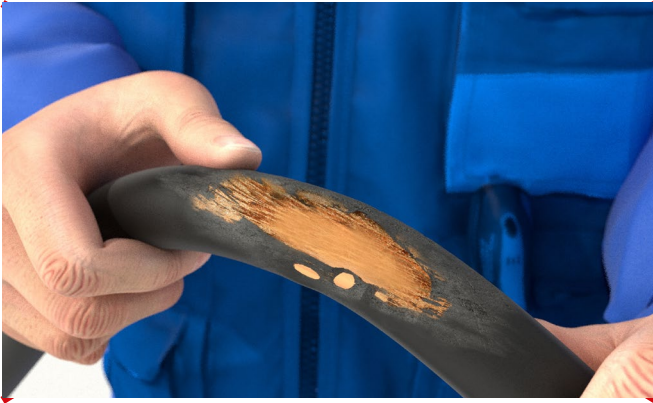
Abb. 12 Beschädigte elektrische Leitung
