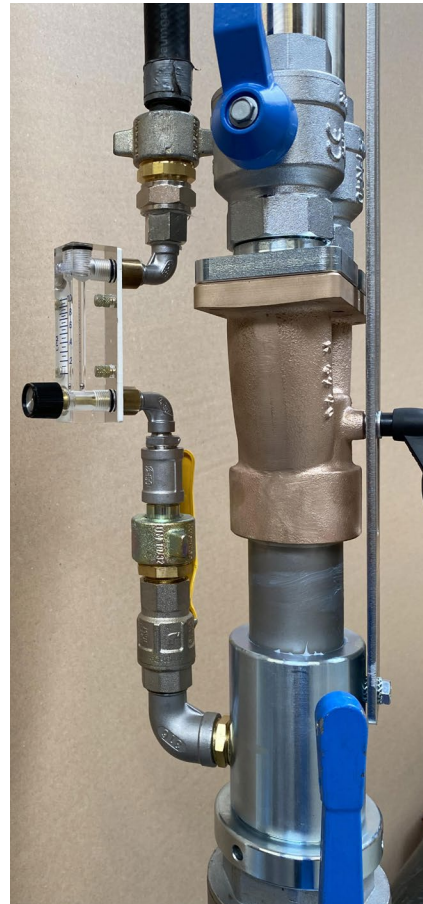
Abb. 31 Beispiel Schwebekörperdurchflussmessgerät zur Kontrolle der Schleichgasmenge
